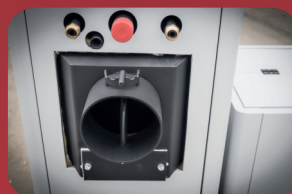
Dimnik in lopute kotla
